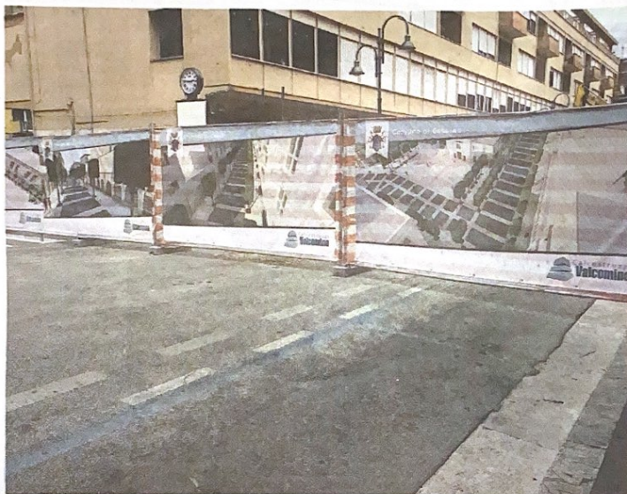
La prima parte del cantiere su cento metri di corso della Repubblica
