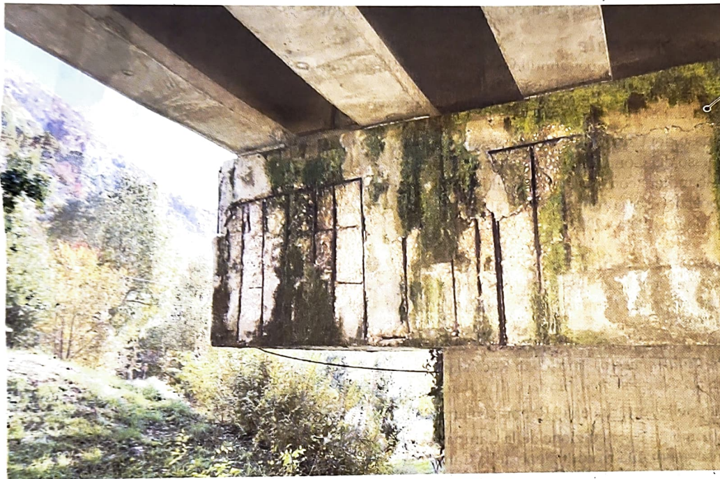
Uno scatto dal basso del viadotto a rischio sicurezza: è sos Nuovi appelli
