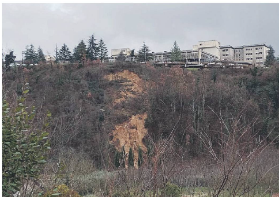
La frana sul versante della collina sopra il quale passa la rampa d'accesso all'ospedale
