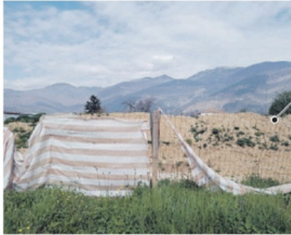
Il cantiere della nuova scuola in costruzione nella zona di Santa Rosalia fermo ormai da molto tempo
