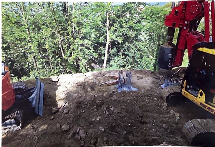
Le armature d'acciaio in cui è stato colato il cemento per realizzare i pali di sostegno
