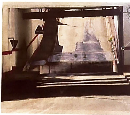
Il sottopasso di via Vivaldi chiuso al traffico da sabato mattina a causa di un allagamento
