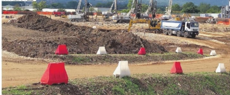
Lavori in corso per la realizzazione del polo del freddo nella zona industriale di Ferentino
