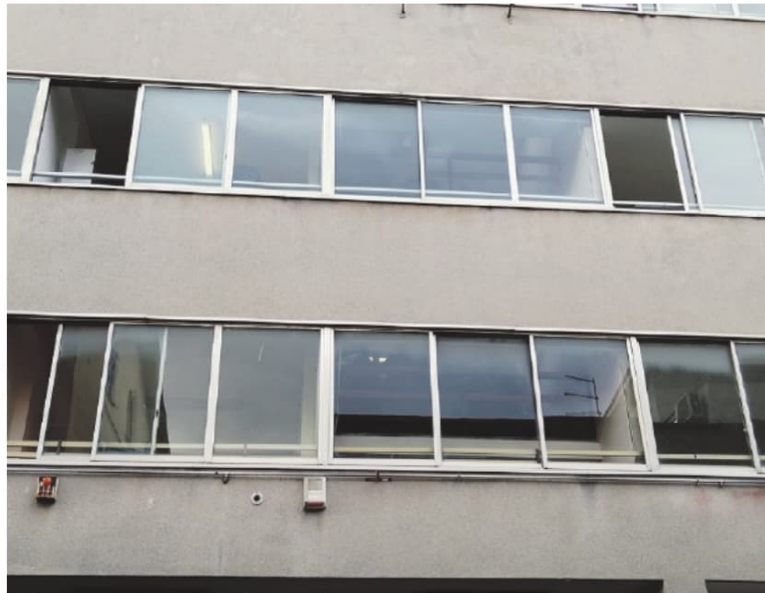
Le finestre dell'edificio che ospita il liceo "Gioberti" dalle quali è entrata la pioggia sabato scorso
