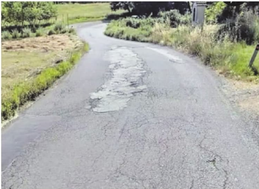
Un tratto dissestato della strada provinciale 14 Pofi-Ceccano
