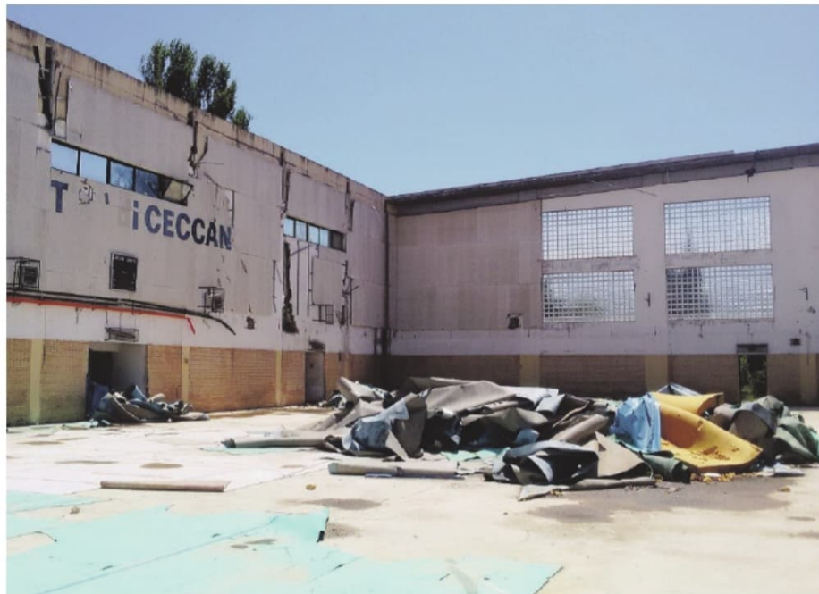
Il palazzetto dello sport "Domenico Tiberia" abbandonato dopo il crollo del 2012. Sotto, il sindaco Roberto Caligiore
