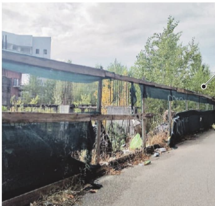
La recinzione dell'area ex Tomassi che cade a pezzi e che il Comune intende sistemare con urgenza
