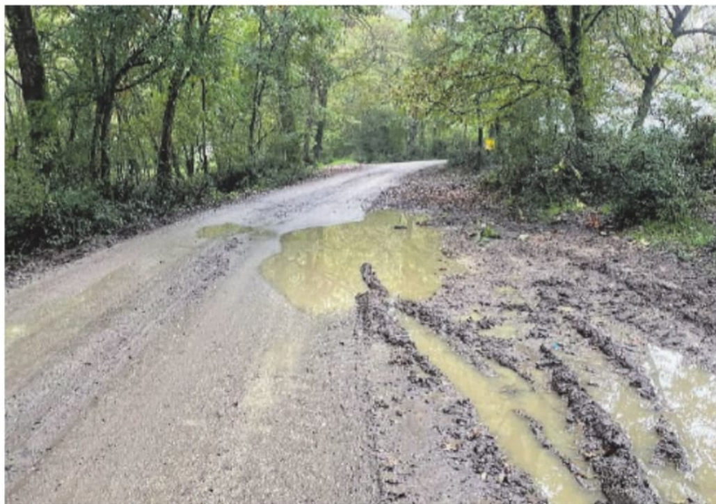
Via Quarallo, percorso alternativo, in condizioni disastrose
