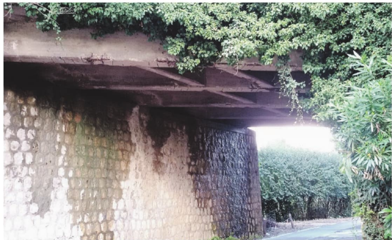
Il ponte sulla Casilina da abbattere e ricostruire: preoccupa la viabilità al momento della chiusura
