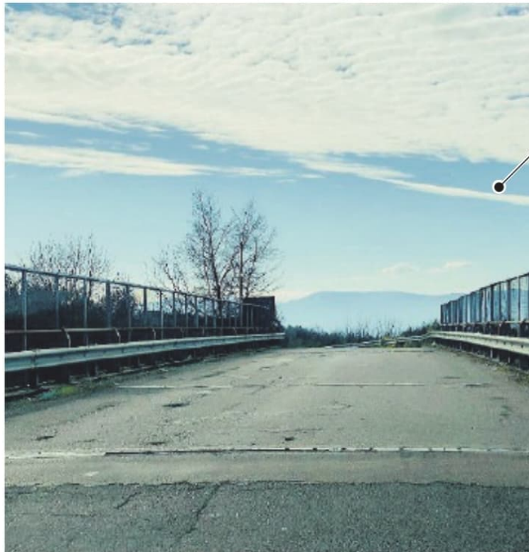
L'asfalto deteriorato sul cavalcavia nei pressi dello svincolo della superstrada
