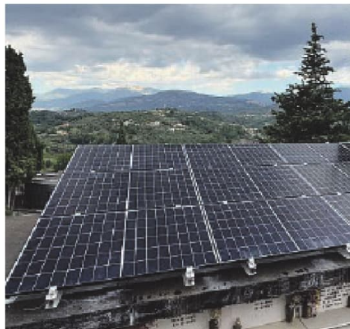
I pannelli fotovoltaici installati al cimitero
