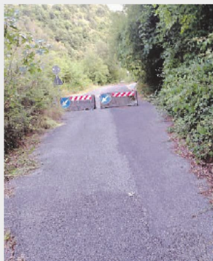
Il “Tracciolino” interrotto da una frana
