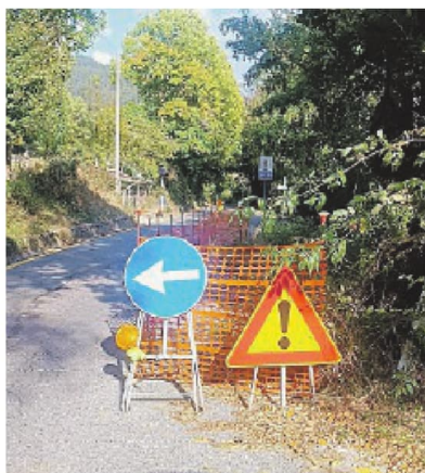
La frana sulla strada fra Trevi e Filettino
