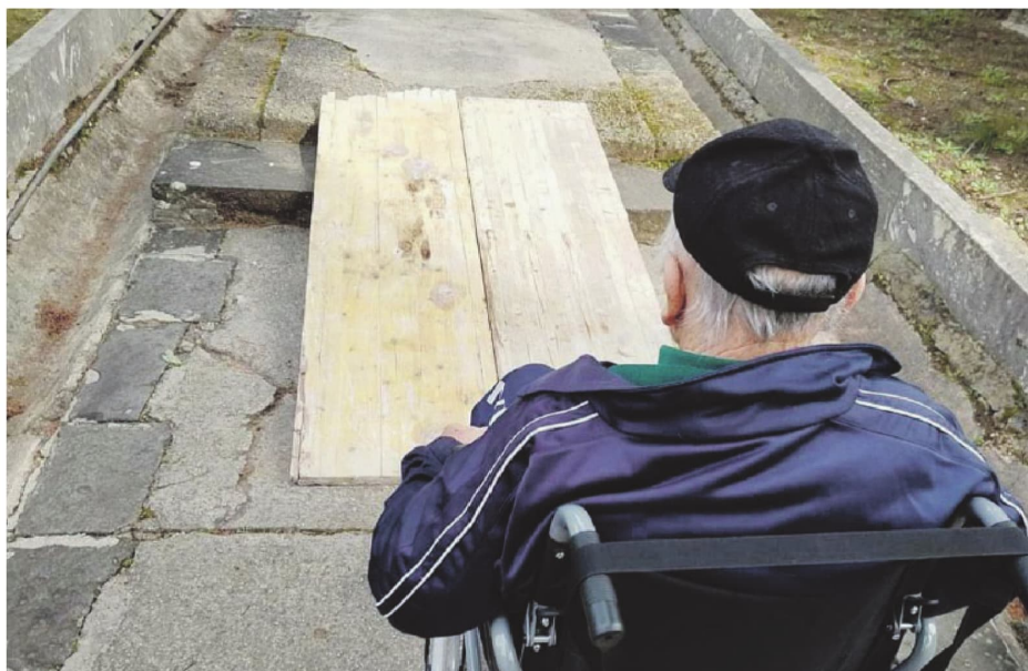
Un disabile costretto a passare su tavole di legno all'interno del cimitero comunale
